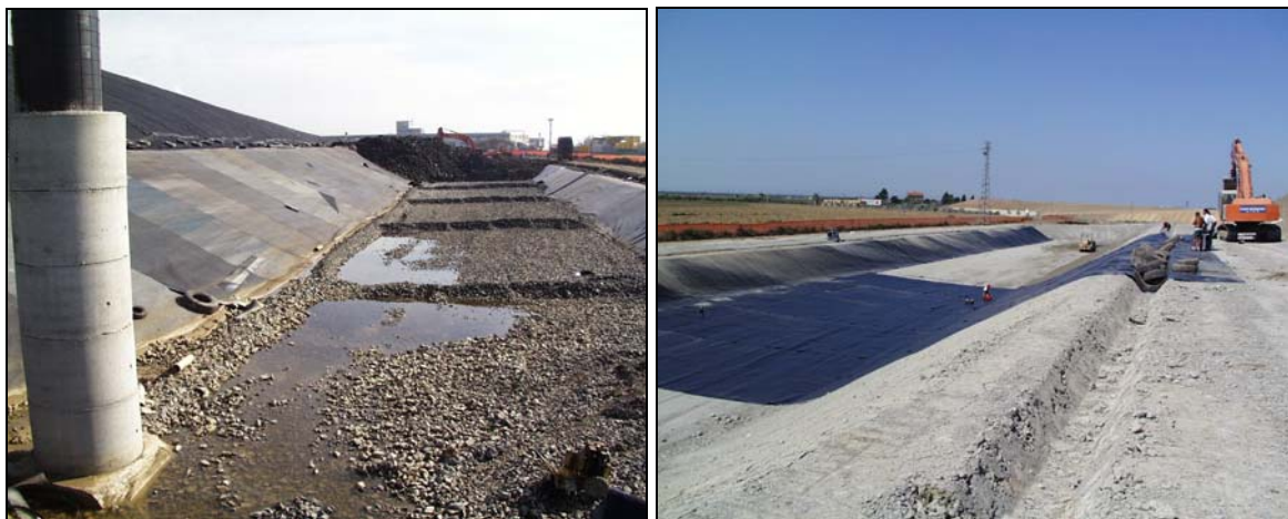
Il pozzo di raccolta ed estrazione del percolato e sistema di impermeabilizzazione
